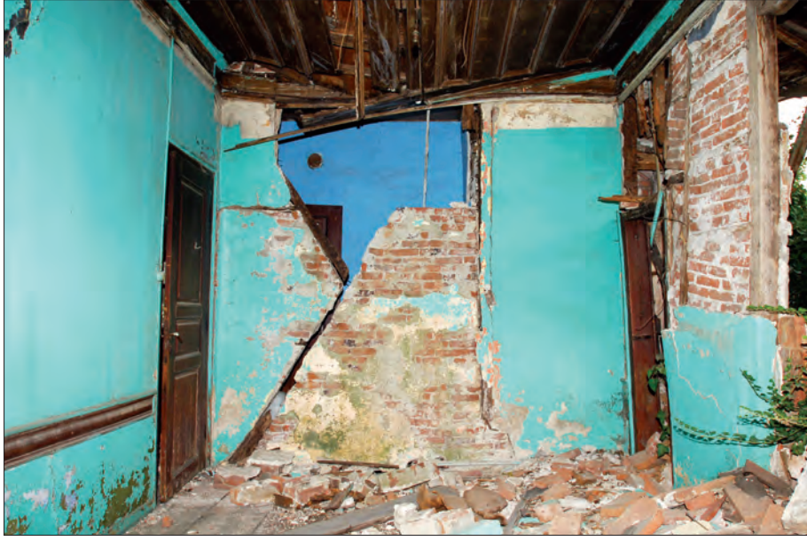
Res. 16. Hamam mekanının yıkılmış duvarları (P.Kapar, 2006)
